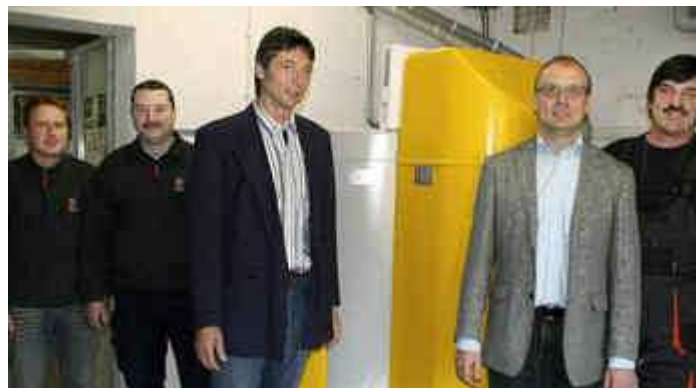
Freuen sich über die neue Pellets-Heizung im Rathaus, von links: Stefan Strittmatter, Andreas Schmidt, Jürgen Pritzel, Bürgermeister Norbert Moosmann und Walter Thoma. | Foto: Peter Schütz
